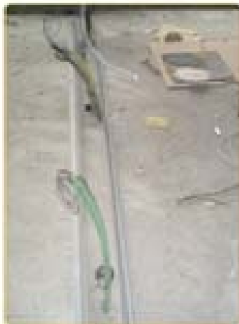
2- Down channel ۲- ریل گذاری کف
